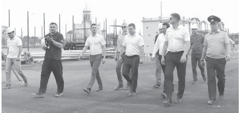
Заместитель Губернатора Краснодарского края Александр Нестеренко с рабочим визитом побывал в Динском районе, где проверил возведение социальных объектов
