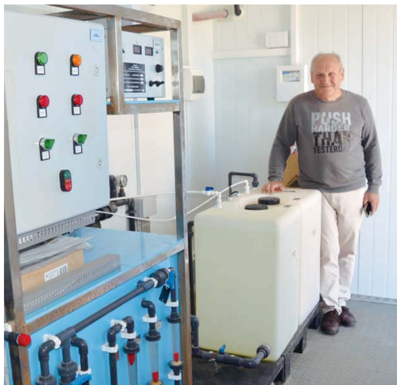
Начальник водозаборных сооружений Виктор Рассохин называет всю эту «игрушечную» технику — электролизные установки, блок дозирования, бак с гипохлоритом натрия и т.д. — сердцем системы обеззараживания питьевой воды
