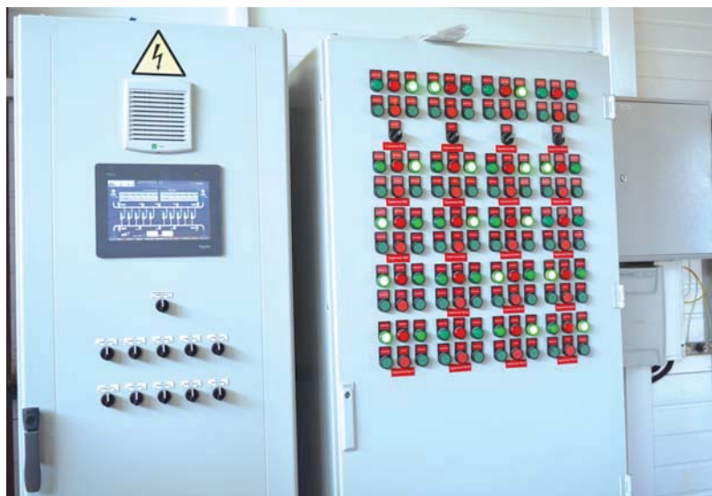
Пульт управления насосным оборудованием станции второго подъема
