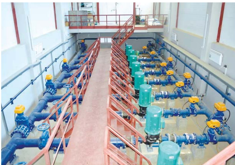
Машинное отделение насосной станции второго подъема
