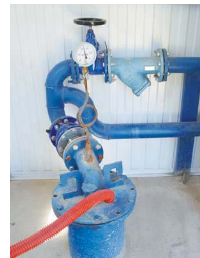
Это миниатюрное наземное устройство — оголовок скважины, которая находится на глубине 350 метров
