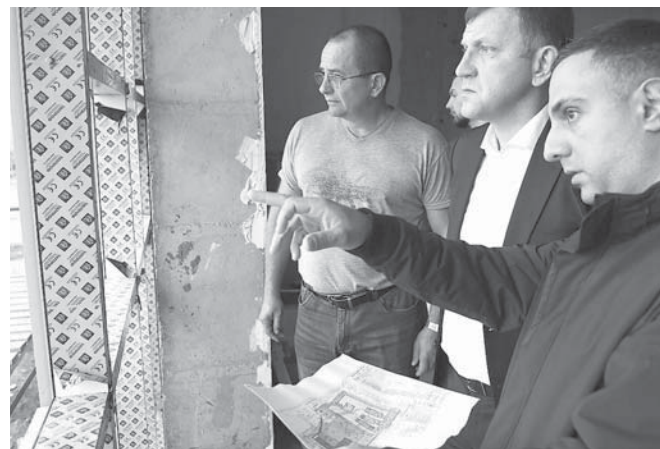
Глава Краснодара Евгений Наумов проконтролировал ход работ по строительству учебного заведения на улице имени Байбакова
