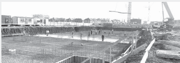
Стартовало строительство детского сада и школы на 1550 мест в районе улицы имени Кирилла Россинского и улицы Батуринской
