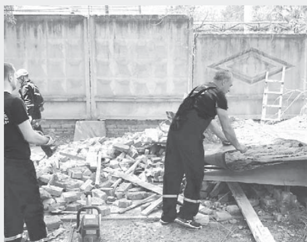
Подведены промежуточные итоги работы по очистке краевого центра от самовольно возведенных зданий и сооружений
