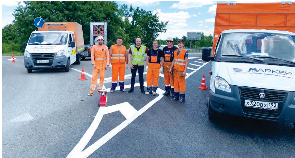
Бригада по нанесению двухкомпонентного пластика холодного формирования на федеральной трассе М4 «Дон» (главный инженер Михаил Подгорский — третий слева, мастер бригады Руслан Безбадченко — первый слева)
