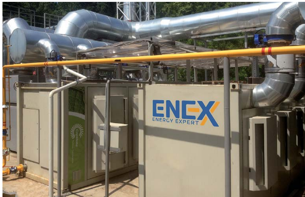
Микротурбинный энергоцентр санатория «Мыс Видный», г. Сочи
